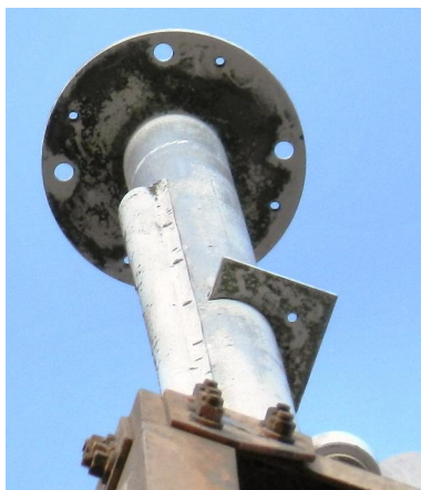
Figura 34 – Antena transmissora principal, na Serra da Bocaina.
